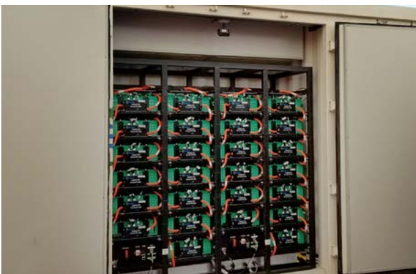
BATERIAS QUE ARMAZENAM A ENERGIA SOLAR DO MARY PICKFORD (EUA)
